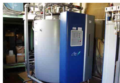
導入したボイラー
